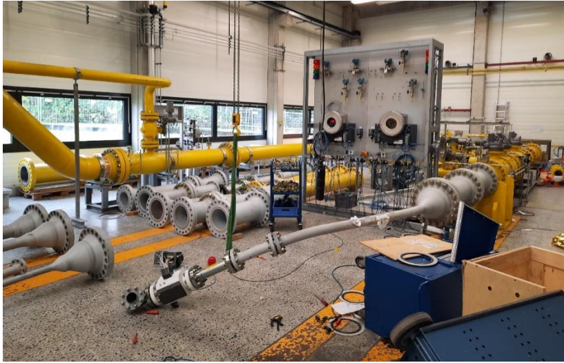
Bild: Prüfhalle Hochdruck-Zählerprüfstand
