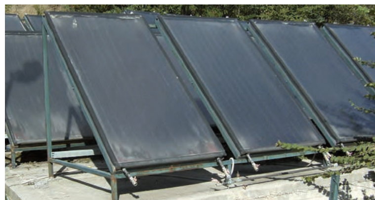
Alte, defekte große solarthermische und nicht nachgeführte Anlage in Griechenland.
